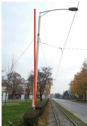
Slika 5. Naginjanje stupa zbog oštećenja na bazi
