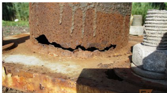
Slika 4. Korozija na čeličnom stupu [17]
